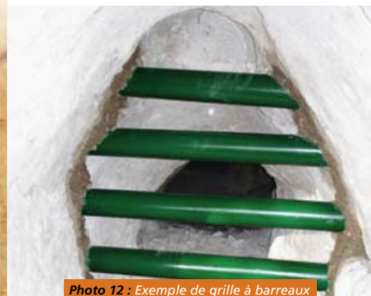
Photo 12 : Exemple de grille à barreaux condamnant l'accès à la cavité.
